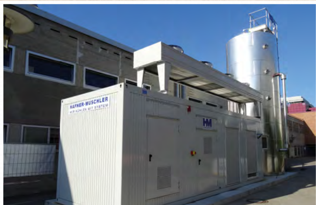
▲ Abb. 183 Die neue Kälteanlage der Mensa Am Adenauerring, 2013
